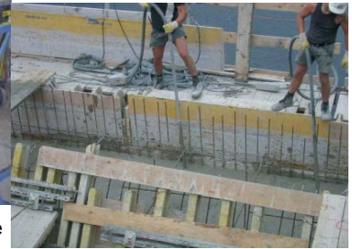
Zagęszczanie betonu na budowie, przy zastosowaniu wibratorów elektrycznych, pogrążalnych z serii NCZ
