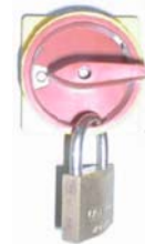
Hauptschalter mit Vorhängeschloß
