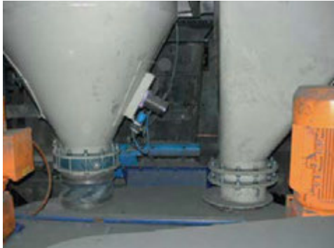
Abreinigen von festen Anbackungen mit Druckluft-Kolbenvibratoren
