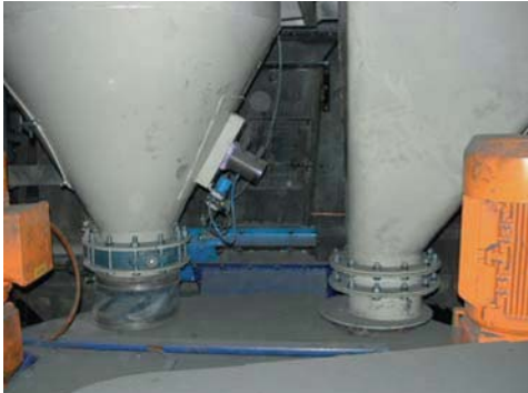
Abreinigen von festen Anbackungen mit Druckluft-Kolbenvibratoren
