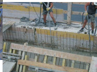
Загущение бетона на строительной площадке, при помощи погружных, электрических вибраторов серии NCZ
